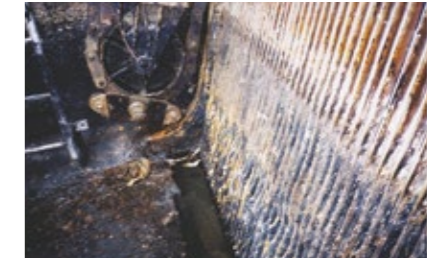
老朽化した機械スクリーン設備
