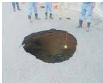
下水道管の陥没状況
