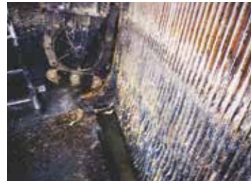
老朽化した機械スクリーン設備
