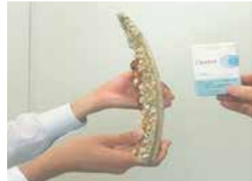
内側のコンクリートが腐食した老朽管
