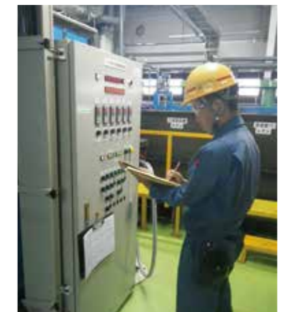
除害施設の稼働状況の確認
