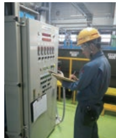
除害施設の稼働状況の確認
