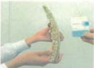
内側のコンクリートが腐食した老朽管
