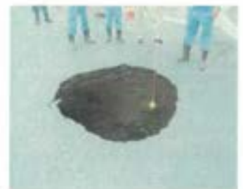
下水道管の陥没状況
