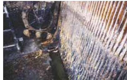
老朽化した機械スクリーン設備
