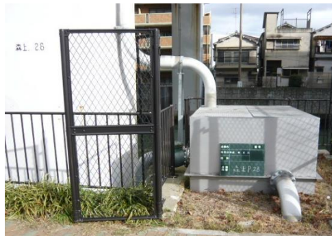
城北川における③排水施設（阪神高速路面排水・排水ピット）
