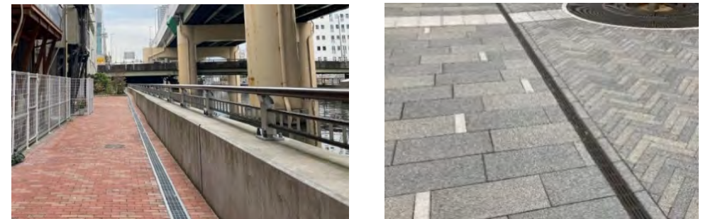
（悪い例）グレーチング側溝
