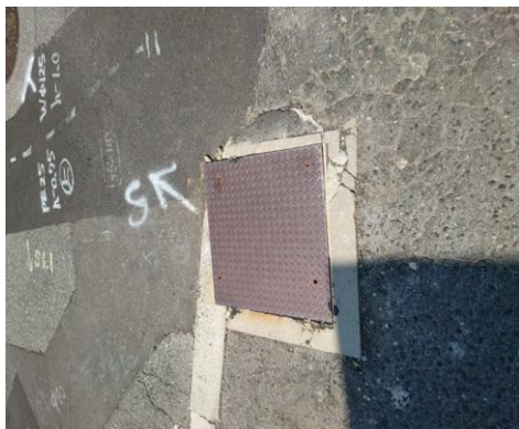
集水ます上部に設置された鉄板
