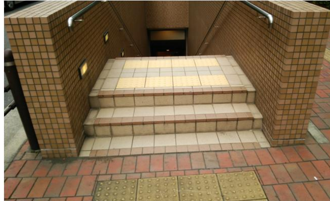
写真10 地下道出入口のマウンドアップ
