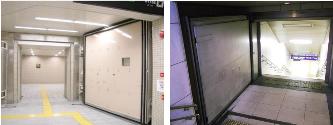
写真 12 地下駅の止水扉
