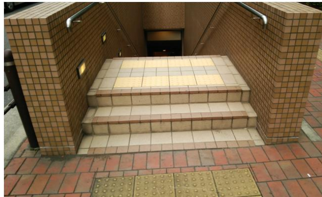
写真10 地下道出入口のマウンドアップ
