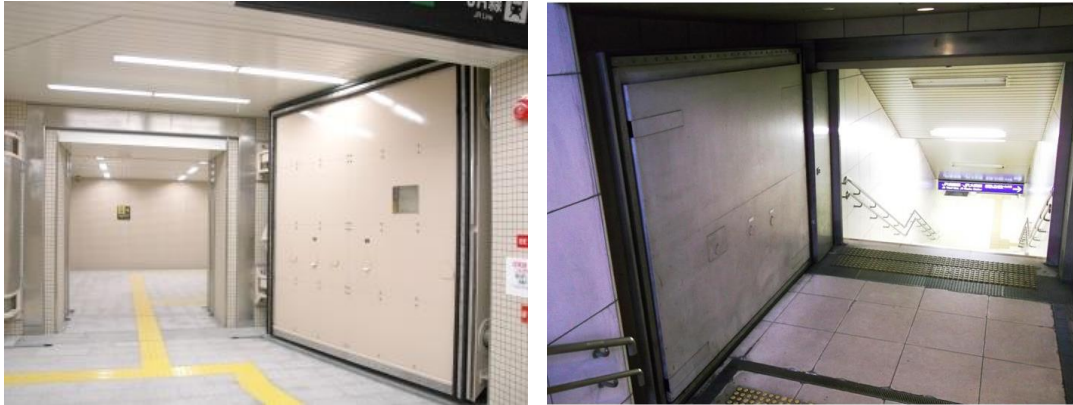
写真 12 地下駅の止水扉
