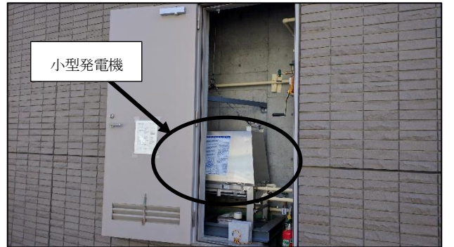
写真 小型発電機設置状況
