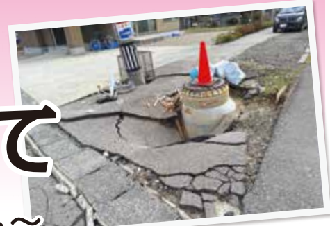
液状化で浮き上がったマンホールがあちこちに
