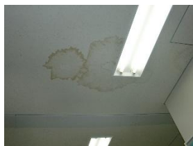
漏水による染み
