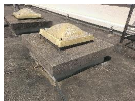
経年劣化したトップライト
