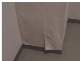
仕上げ材の剥がれ
