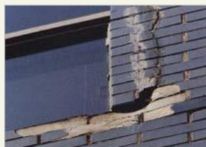
タイルの浮き・割れ
