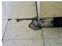
床仕上げ材の剥がれ
