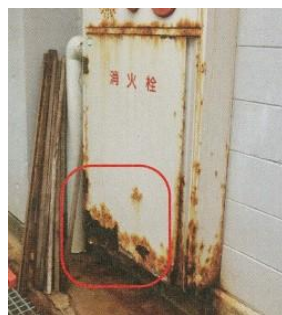
消火栓の損傷 ◆10
