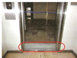
エレベーター扉の段差 ※12
