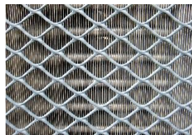
室外機フィン
