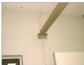
壁のひび割れ
