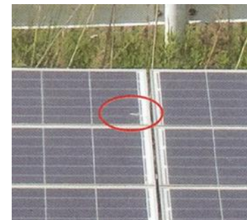
太陽光パネルの損傷 ◆9
