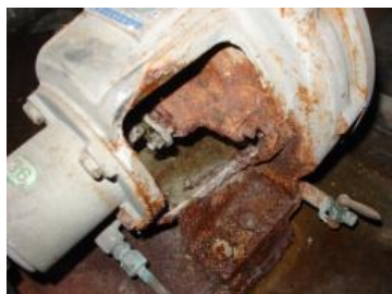
ポンプの腐食
