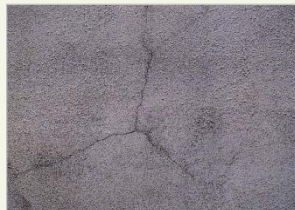
モルタルのひび割れ
