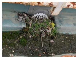
ルーフトレンの清掃不良
