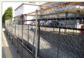
フェンスのさび
