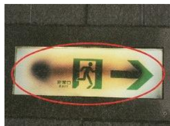
誘導灯の表示不良 ◆11
