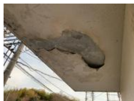
庇部の仕上げ材の剥れ
