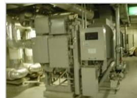
冷温水発生機
