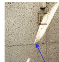
仕上げ材のひび割れ
