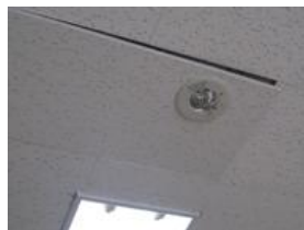
天井ボードの剥れ❖ 1
