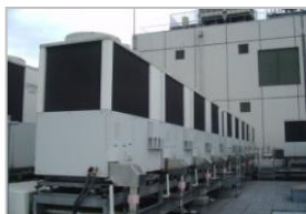
個別空調室外機
