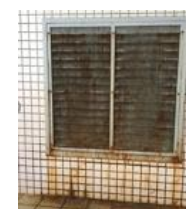
吸入口の腐食
