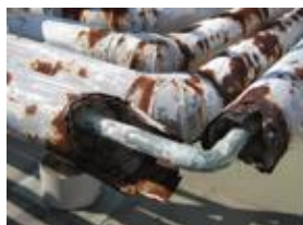
配管断熱材の損傷
