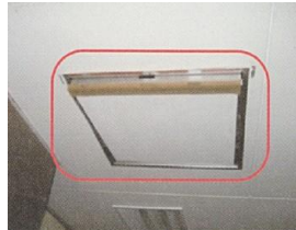
点検口の開閉不良❖ 2
