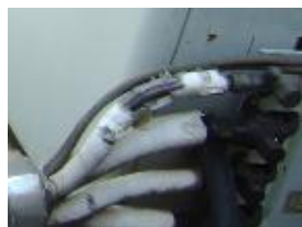
配管断熱材の剥れ
