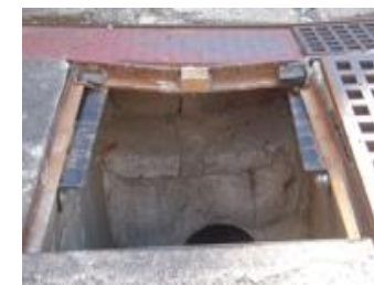
枠の損傷（蓋の浮きの原因）
