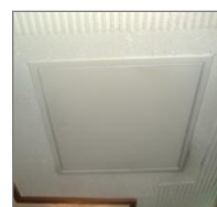
排煙口 (通常閉鎖)
