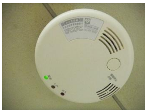
ガス漏れ警報器
