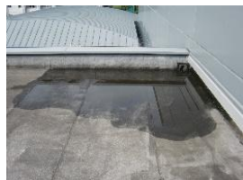
不陸による水溜まり
