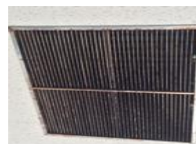
吹出口の錆と汚れ
