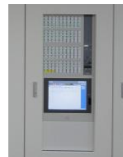
中央監視装置
