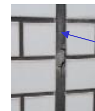
目地ひび割れ
