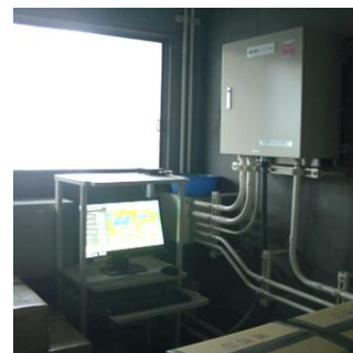
パワーコンディショナー ※換気口は盤側面等
