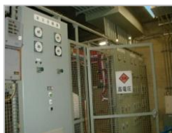
開放型電気室
