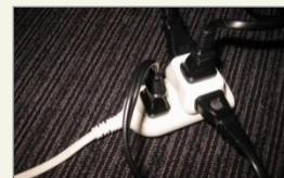
電気器具のつなぎすぎ
