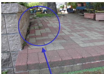
舗装の不陸や傾斜
