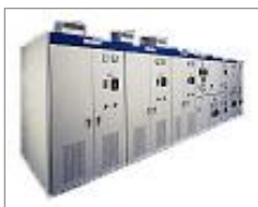
屋内型キュービクル (電気室設置)
