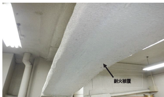
図表－1 石綿含有吹付けバーミキュライト耐火被覆
