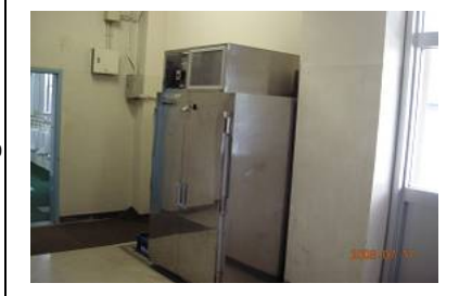
牛乳保冷库 (1階に設置)
