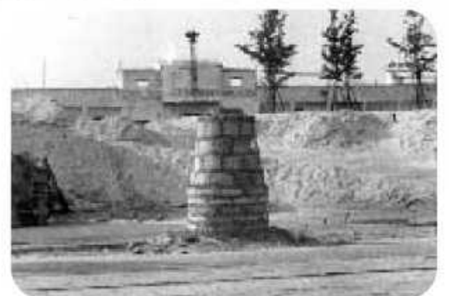
盛土後の路面高に合わせた 下水道マンホール（市立運動場 （現八幡屋公園）付近、昭和32年）
