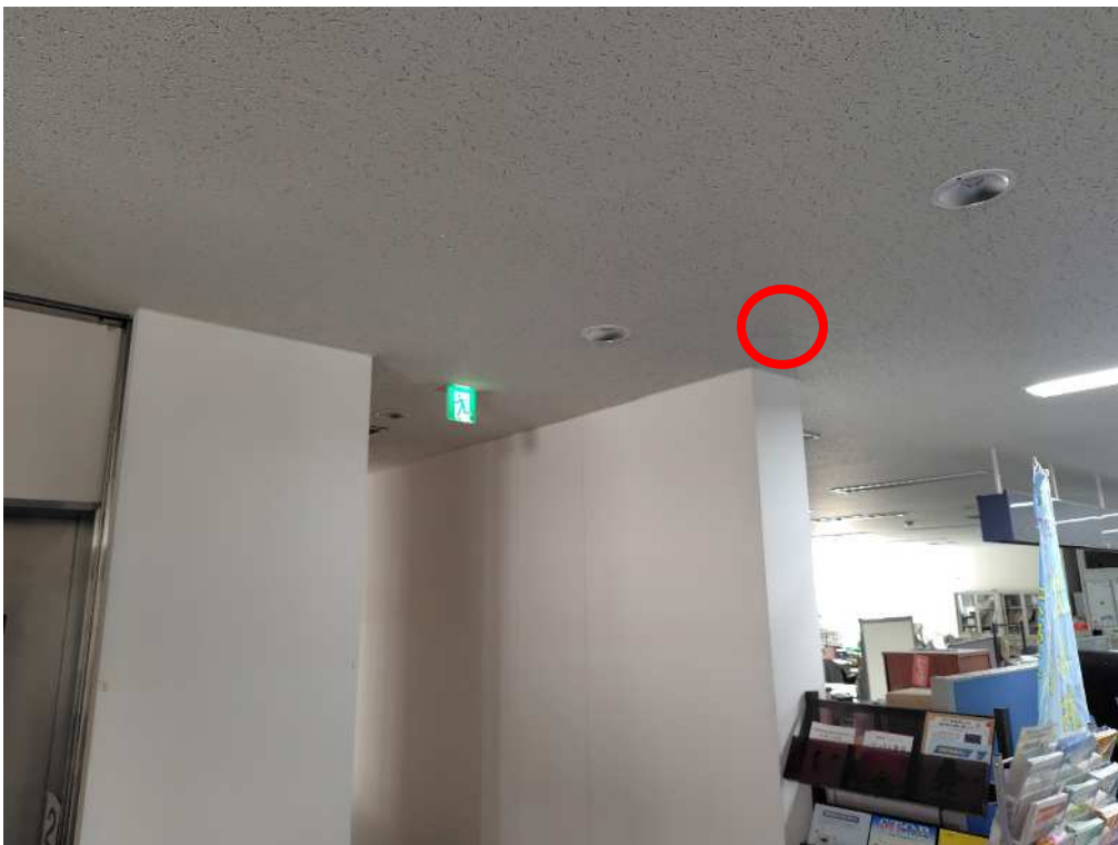
新設カメラ （2階）
