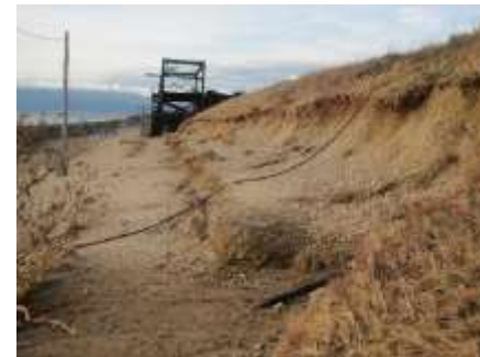
夢洲G護岸背後 盛土の法面洗掘
