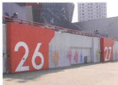
防潮扉(港区埠頭26)
