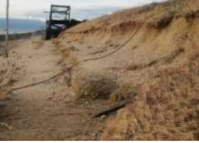
(盛土の法面洗掘)
