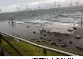
(転落防止柵破損)
