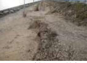
(盛土の法面洗掘)
