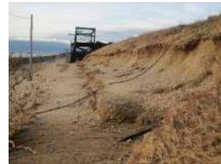
夢洲G護岸背後 盛土の法面洗掘
