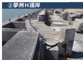
(護岸上部コンクリートブロック破損)
