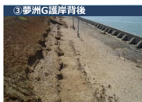
(盛土の法面洗掘)
