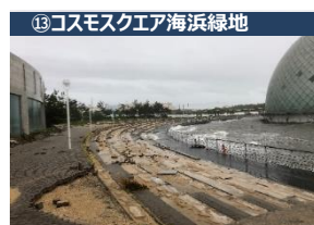
(ブロック舗装・階段部破損)
