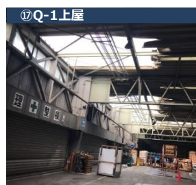
(上屋屋根破損)
