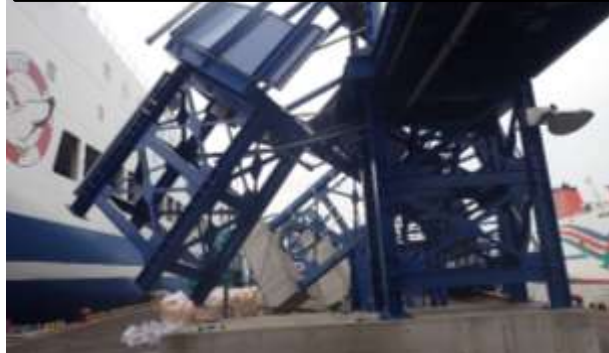
⑦ボーディングブリッジ倒壊状況（近景）
