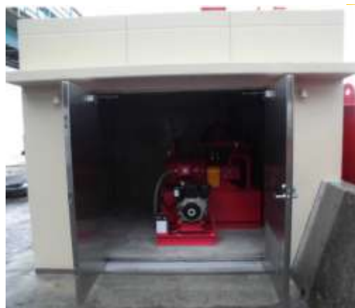
非常用電源200kVA
