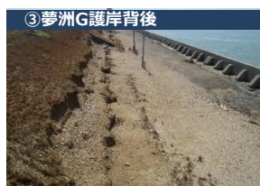
(盛土の法面洗掘)
