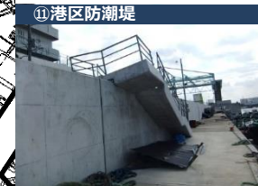
(防潮堤階段部の破損)
