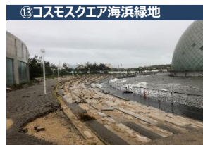
(ブロック舗装・階段部破損)
