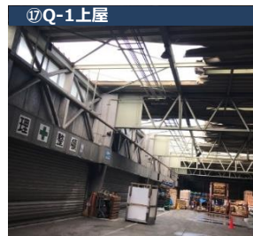
(上屋屋根破損)
