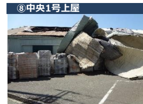
(上屋屋根破損)
