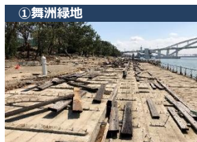
(A'ートワーク破損)
