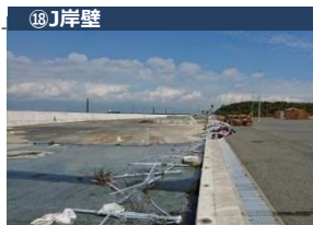
(ソーラフェンス破損)
