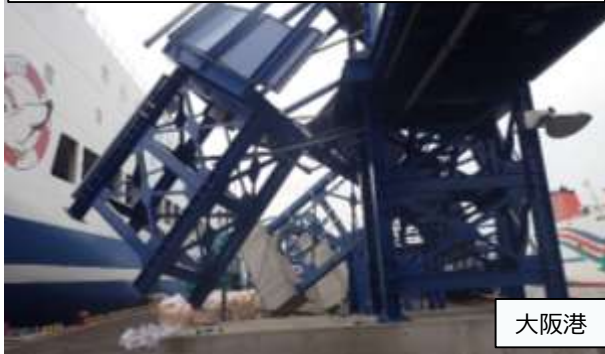
ボーディングブリッジ倒壊状況（近景）
