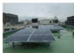
屋上に設置した太陽光発電設備
