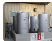
大型貯蔵タンク
