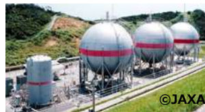
液化水素タンク
