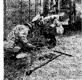
消火センを点検する消防署員。火センがすぐに発見できるように標示板もたいせつにしてください。
