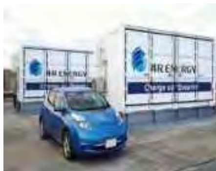
○EVリユース蓄電池
