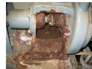
劣化が進行している設備(ポンプ)の事例
