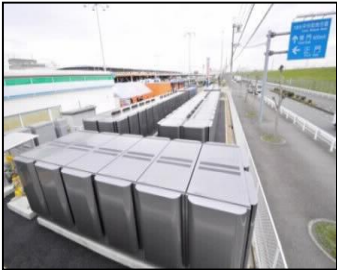
○中央卸売市場の燃料電池
