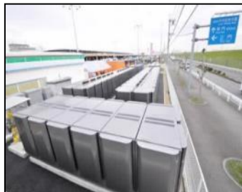
○中央卸売市場の燃料電池
