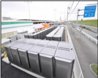
○中央卸売市場の燃料電池
