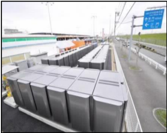
○中央卸売市場の燃料電池
