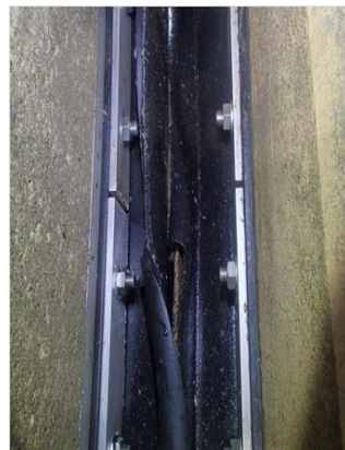
大放水路とポンプ室の ジョイント部の破損状況
