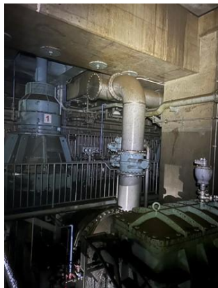
雨水ポンプの状況
