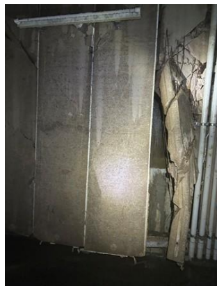
仕切り壁の破損状況
