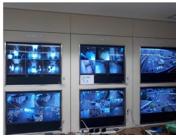
監視モニター
