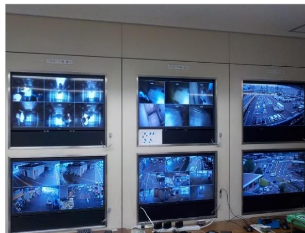
監視モニター
