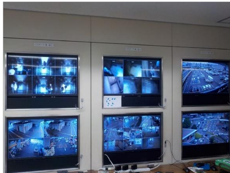
監視モニター
