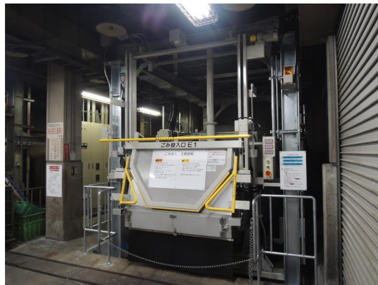
塵芥処理設備
