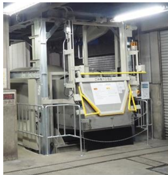
塵芥処理設備
