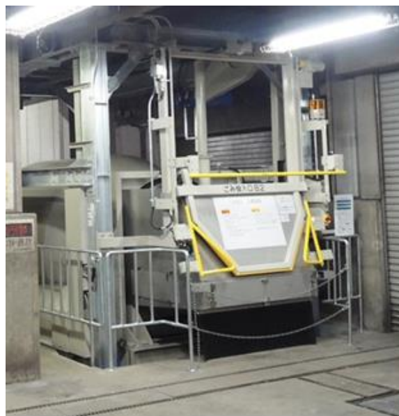
塵芥処理設備
