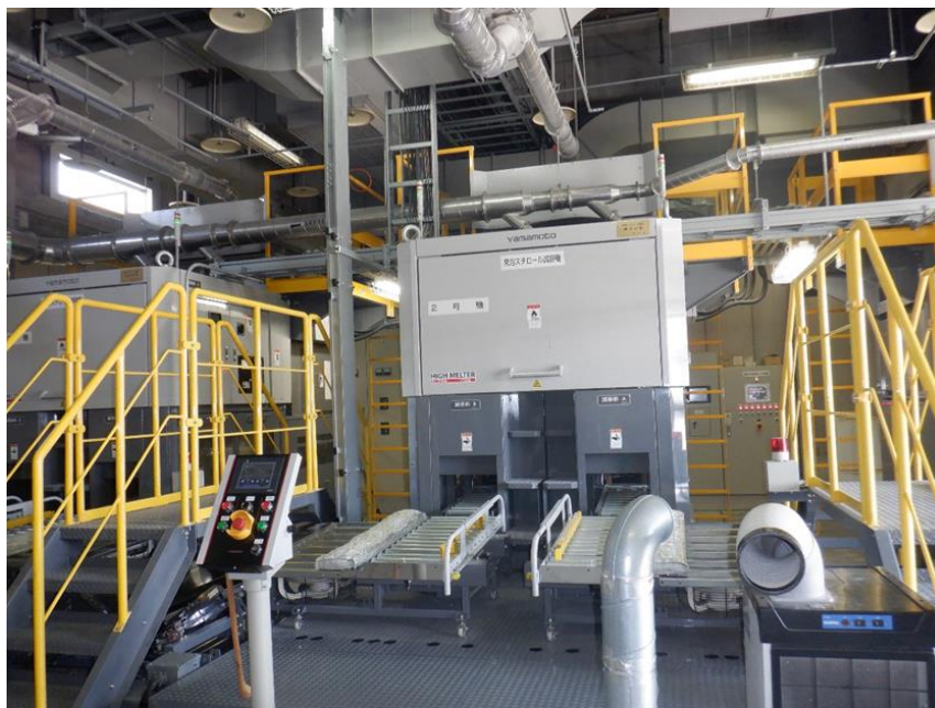
発泡スチロール処理設備
