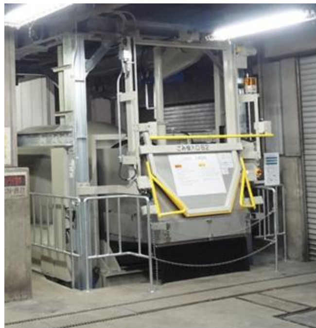
塵芥処理設備
