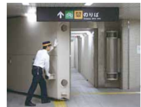
駅出入口止水扉
