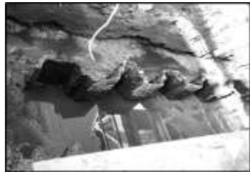
交差部で発生した地中障害物(鋼矢板)
