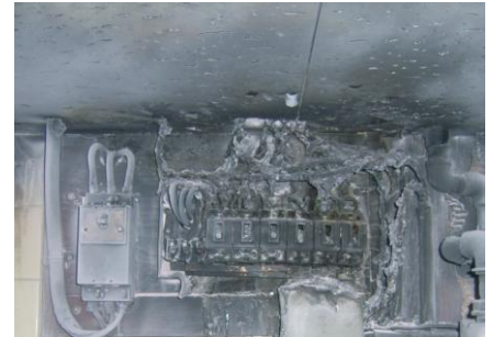
焼損した分電盤
