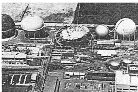
屋外貯蔵タンクの傾斜
